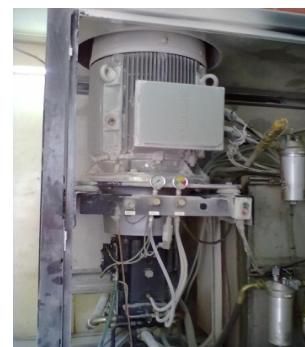
Gambar 8. Motor induksi dan pompa hidrolik di mobile crusher
